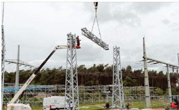
Mit einem Autokran wurde das Freileitungssportal, die Anbindung des Umspannwerks an die Hochspannungsleitung, eingehoben und installiert. F. T. Schaller
