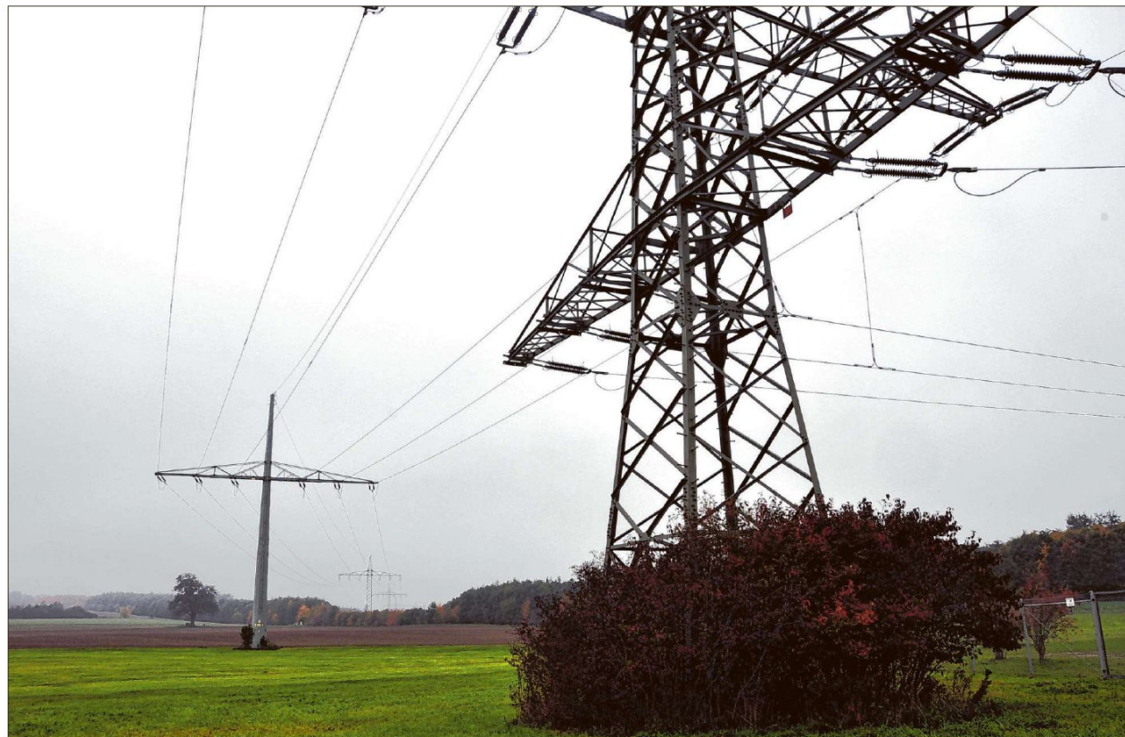
Als „Autobahnauffahrt“ ins Stromnetz kann das Umspannwerk bei Wiedersbach fungieren. Deshalb interessieren sich Investoren für die angrenzenden Flächen als Standort für große Photovoltaikanlagen. F.: Wolfgang Grebenhof
