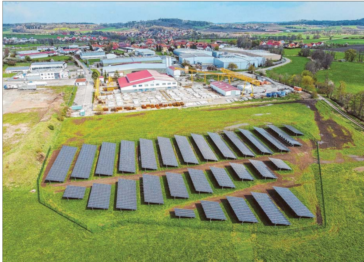
Dem Stromverbrauch von 200 Haushalten entspricht die Gewinnung von Solarenergie durch die Photovoltaikanlage des Unternehmens Dennert am Standort Wörnitz. Foto: Torsten Küster
